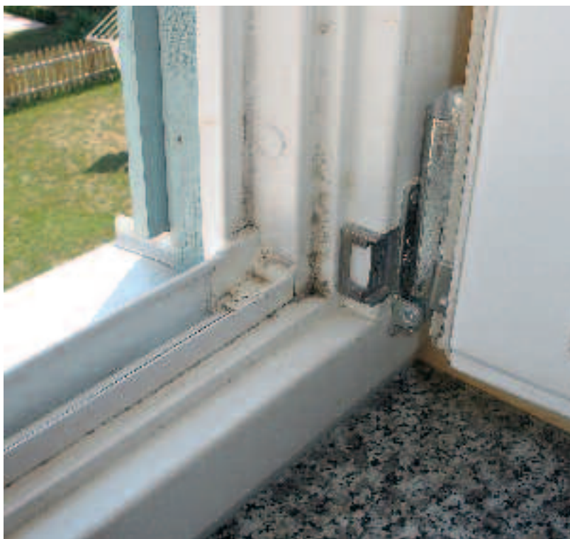
Immer häufiger treten in dichten Gebäuden an Fenstern Schimmelpilzschäden im Dichtungsfalz auf.
