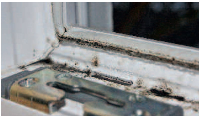
Kunststofffenster mit innerer Überschlagsdichtung. Bereits kleinste Fugen an der Drehkipp-Schere reichten aus, um diesen Schaden entstehen zu lassen. Die relative Luftfeuchtigkeit im Haus betrug bei plus 21 Grad Celsius Zimmertemperatur 41 Prozent.
